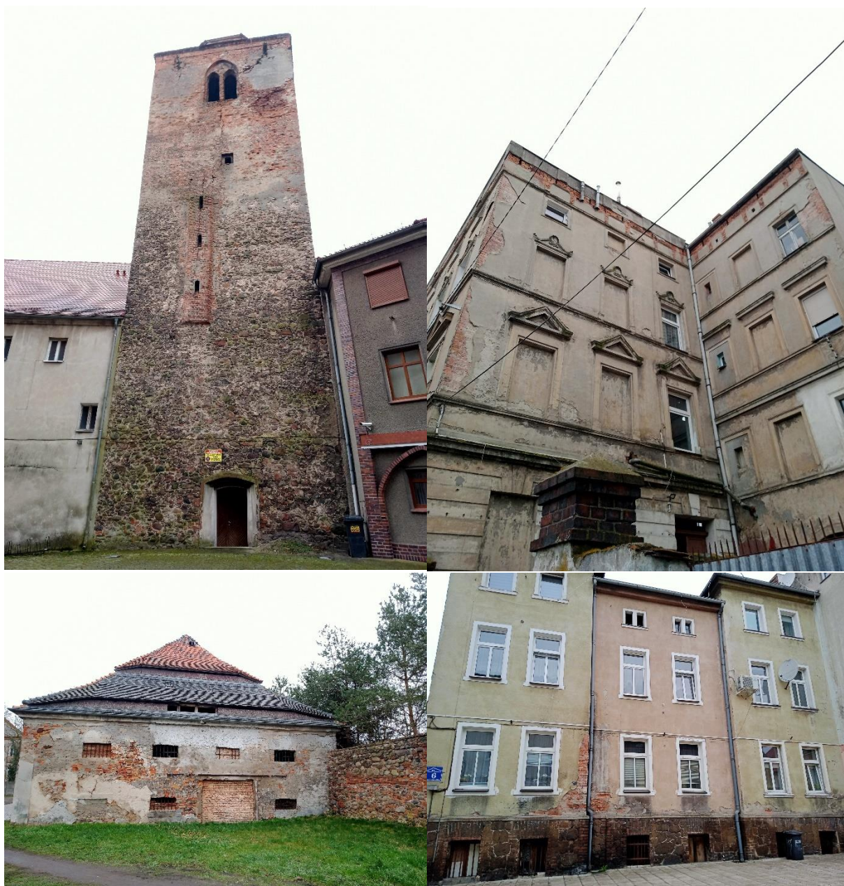
Rycina 21 Przykłady obiektów wymagających poprawy stanu technicznego na obszarze rewitalizacji Żary 4
